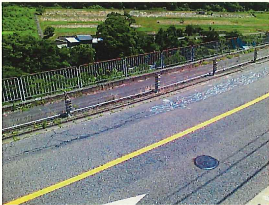
図-6 国道 9 号線の轍 (写真の白い部分)
